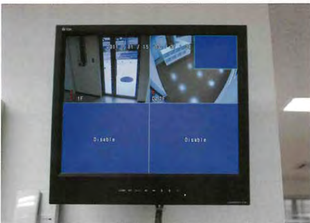
事務所で監視できるモニター
